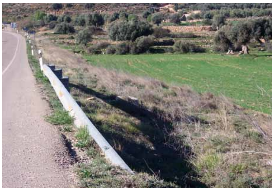
Figura 6. Indicador de barrera = 3: Existencia de barrera cuya disposición no se ajusta a los criterios de las Recomendaciones sobre sistemas de contención de vehículos.
