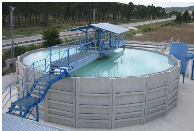
Fotografía 2: Tanque clarificador para decantación de caolín de tamaño inferior a 44 \mu\text{m} .
