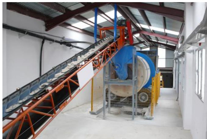
Fotografía 1: Tromel donde se produce el proceso de lavado.
