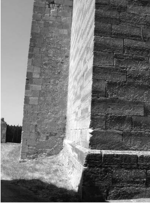
Figura 7 Esquina muro sur - muro oeste. Se observa la disminución en la sección cierta altura sobre rasante
