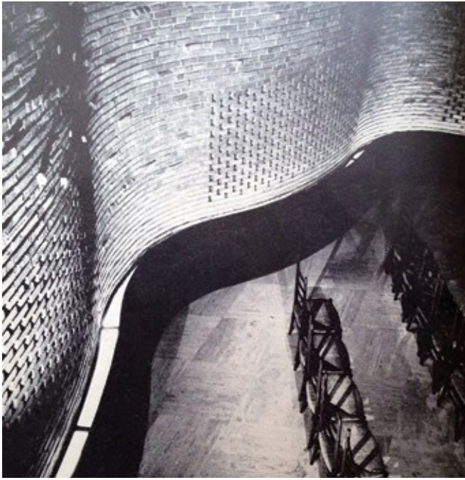
(9) La ondulación del muro perimetral interior.
