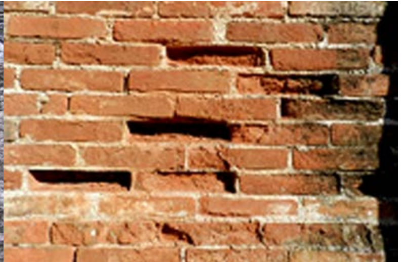
22. Muro norte de ladrillo en la versura oriental, deplacación frontal de los módulos de ladrillo causado por la incompatibilidad con el mortero original de junta.
