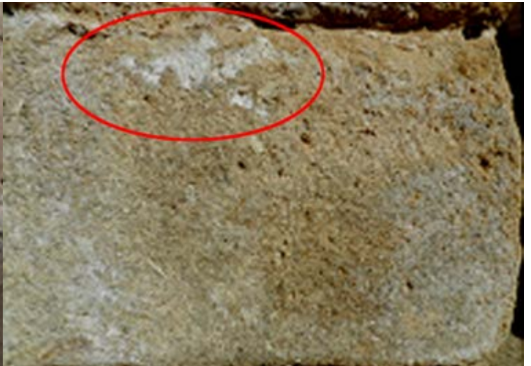
7. Eflorescencias salinas en diversos puntos del basamento del frente escénico
