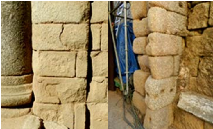
17a. 17b. Vano de acceso a las galerías en la versura oriental, deplacación frontal de los sillares de granito y erosión de las zonas más expuestas.
