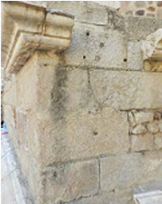
5. Escorrentías por agua de lluvia en las cornisas del basamento.
