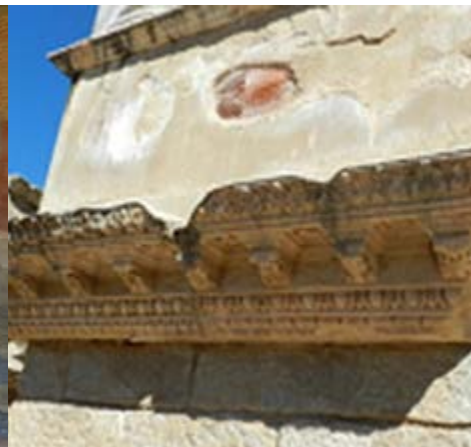
14. Degradación del mortero que revistía el falso plinto del segundo orden
