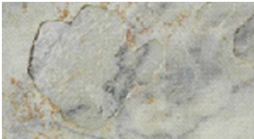
19. Exfoliación superficial en las placas de revestimiento marmóreo del podio en el frente escénico.
