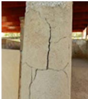
12. Daños provocados por la aplicación de morteros de cemento sobre las columnas graníticas del peristilo en Casa del Mitreo
