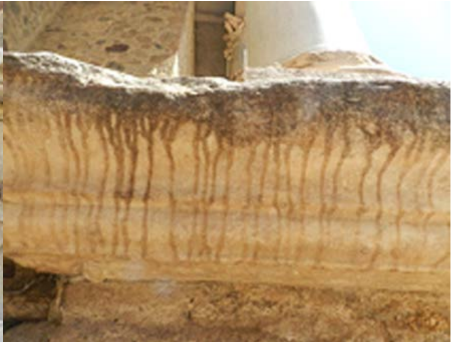
6. Marcas de escorrentías en las cornisas de mármol blanco, estas marcas son características de superficies tratadas con productos hidrofugantes (ICOMOS, 2008)
