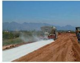
2.Extendido de la cal: La distribución se realiza mediante un dosificador volumétrico que se controla por la velocidad de avance de la unidad de extendido.
