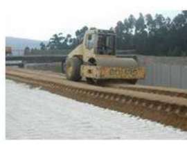
5.Compactación: La mezcla se compacta por medio de compactadoras neumáticas en tongadas sucesivas. Se necesita un control riguroso de la humedad óptima de compactación de la capa de suelo-cal.
