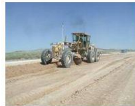
6.Refino: Finalmente se pueden refinar las capas superiores. Esta operación se flexibiliza con el uso de la cal, pudiéndose realizar hasta das después de la mezcla y compactación.
