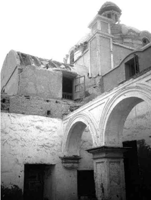
Figura 16. Bóveda y cúpula encamónada de la iglesia La Compañía de Pisco (HURTADO VALDEZ, 2004).
