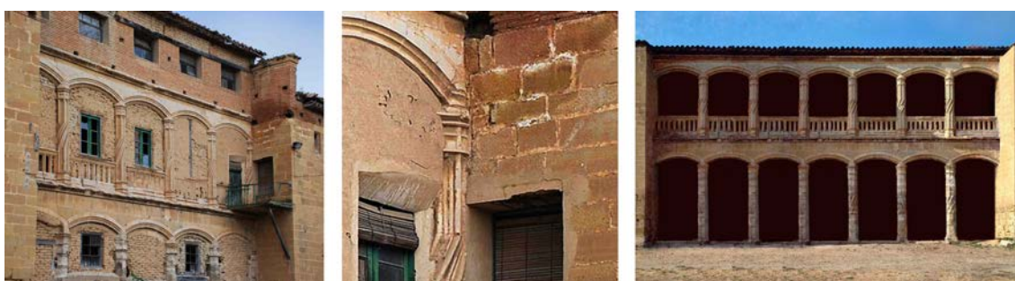
Figs. 309, 310 y 311. Palacio-villa de Casalarreina. Izquierda y centro: la galería tardo-gótica y su encaje defectuoso con los cuerpos laterales (foto de Barrón García, 2013, p. 278). Derecha: hipótesis sobre una galería de siete vanos (elaboración propia sobre imagen 2GPMWMH, fondo http://www.Alamy.com , 2022).
