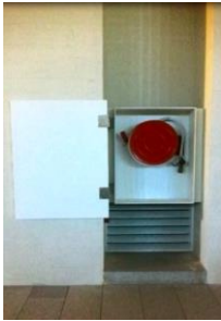
3.70 Protección activa contra incendios
