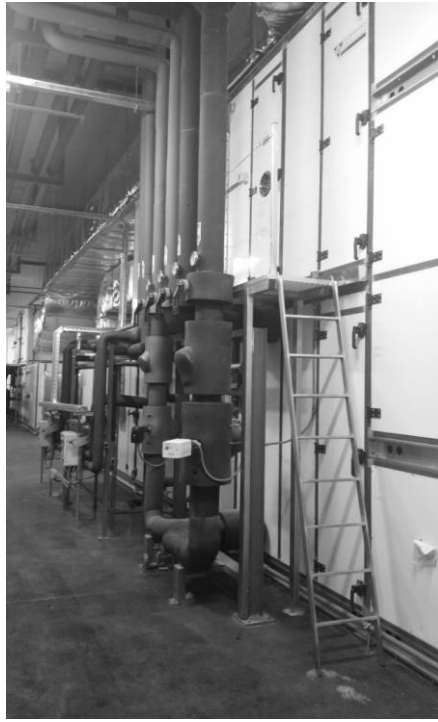
3.42 Patinillo de instalaciones
