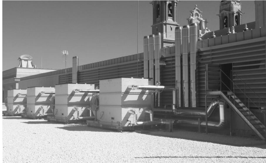
3.53 Enfriadoras en la cubierta del edificio
