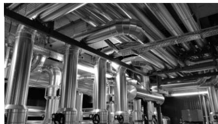
3.47 Conductos de climatización
