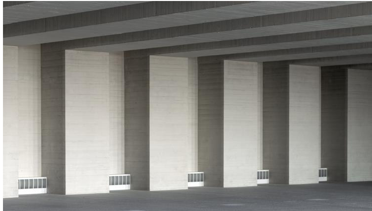
3.66 Secuencia de rejillas de retorno
