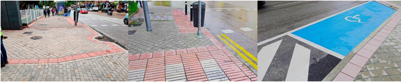
Figura 51. Estado ejecutado de aceras, zona de estacionamiento PMR y de barandilla para mobiliario no ejecutada finalmente en calle Alcalá (mayo 2025).
