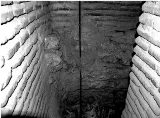
Figura 9 Muro perimetral de la torre en el que se ve el paso del calicanto a la fábrica de ladrillo
