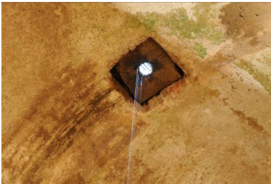
Fig. 10. Bóveda de la nave 2. Almagras arrastradas por el agua.
