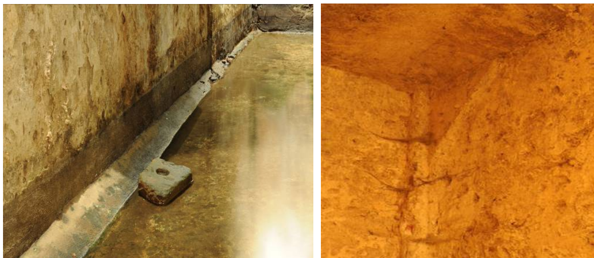
Fig. 2. Escocia en el perímetro del pavimento. Fig. 3. Bocel (esquina O debajo de meseta de escalera)
