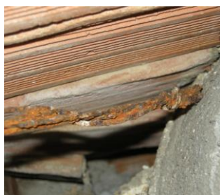
5.1: Corrosión de alambres
