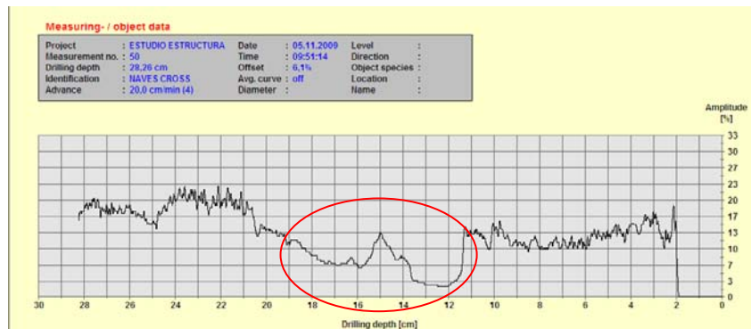
Fig 6. Nudo D de la Cercha 12 de la Nave 1 donde se aprecia una bajada de la grafica entre los 11,5 y 14 cm desde el origen que continua entre los 15 y 17 cm lo que significa la existencia de una pudrición entre los 11,5 y 17 cm.
