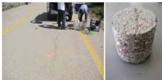
Figura 6. Aspecto de la fisuración descendente en la carretera N-111 (la fisura afecta a la capa de rodadura y muy poco a la intermedia).
