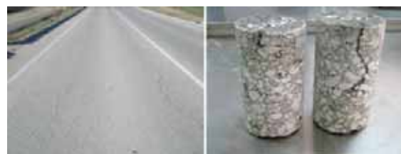
Figura 2. Aspecto de la carretera C-681 y dos de los testigos extraídos.
