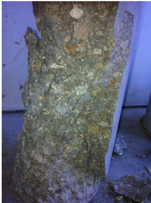
Figura. 7.- Rotura eficiente de probeta de hormigón.
