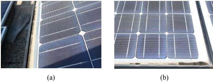
Figura 3. Defectos visuales aparecidos en los módulos tras 16 años de funcionamiento: (a) roturas y (b) musgo en la unión entre el marco metálico y el laminado.
