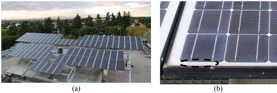
Figura 1. (a) Vista general de la instalación. (b) Vista en detalle de uno de los módulos. La separación de 2 cm entre el marco y las células en la parte inferior del mismo ha evitado que la suciedad afecte al rendimiento energético y a la seguridad eléctrica.
