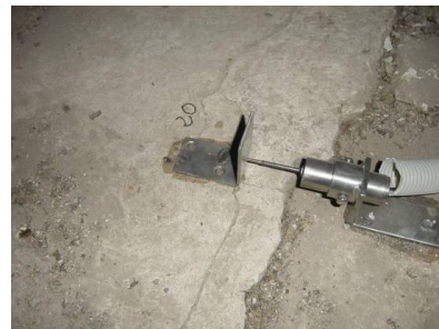
Foto 3.- Medida con fisurómetro
