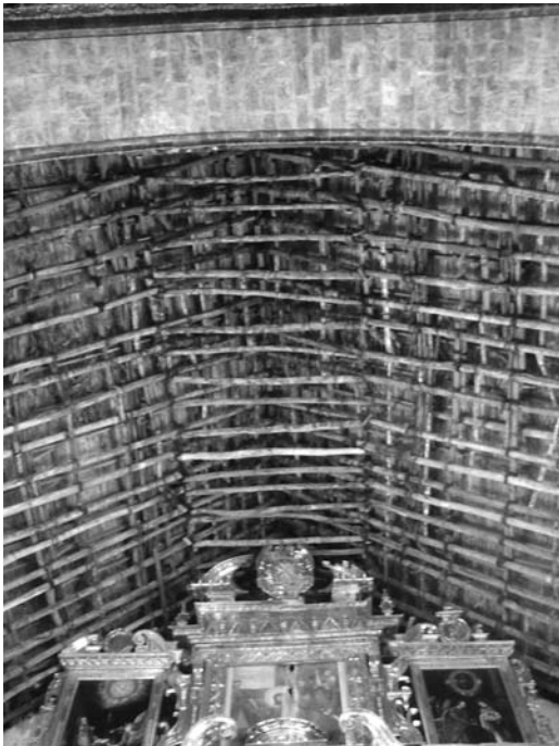
Figura 4 Armadura de cubierta de la cabecera de la iglesia de San Juan de Juli
