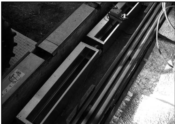
Figura 5. Compuertas de entrada y salida del aire.
