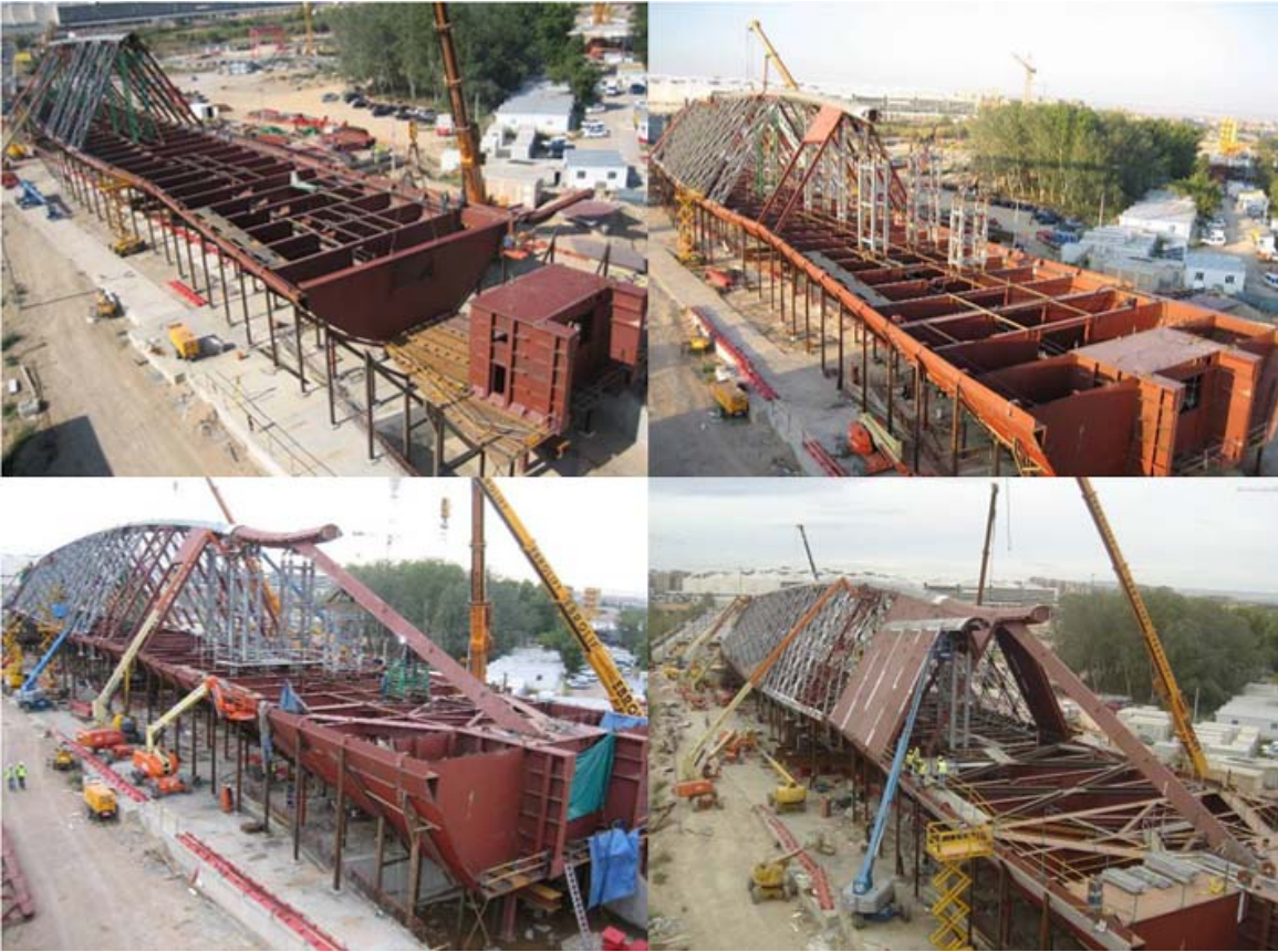
Fig.8 Montaje de la parte sur de la estructura. Cajón, cordón superior, patas, costillas y paneles de fachada.
