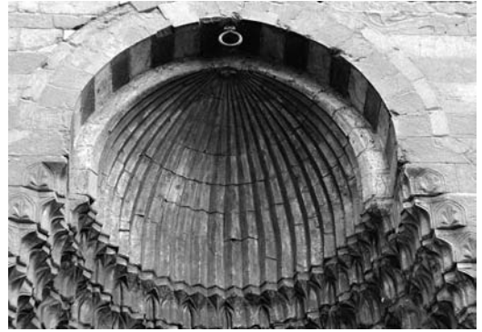
Figura 5 Pequeña cúpula aparejada por hiladas de dovelas girando alrededor del eje vertical. Fachada principal de la mezquita del sultán Hassan (foto del autor 2013)
