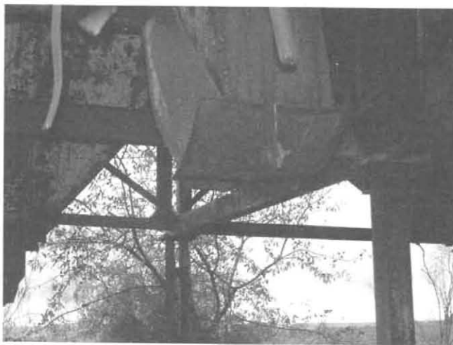
Fig.-6.-Detalle del dosificador de una de las tolvas.
