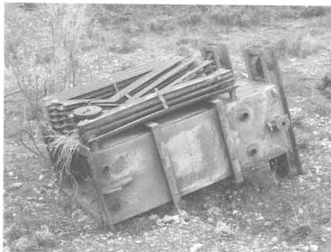
Fig.-7.-Transformador abandonado en las proximidades de la cantera
