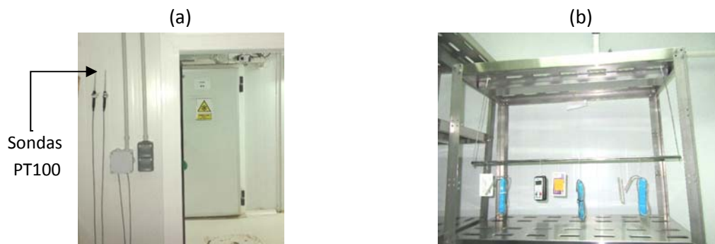
Figura 3. (a) Ubicación de la sonda (PT100) en el interior de una cámara. (b) Sensores colocados en la estantería de una de las cámaras
