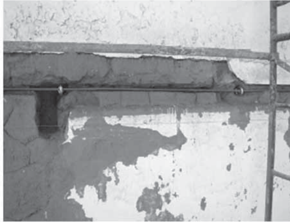
Fig.11: Cables horizontales metálicos aplicados al exterior de los muros. (Gráfico: E. Toelles, 2002. Foto: J. Vargas, 2005).
