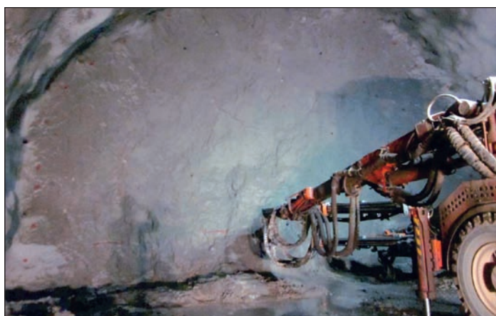
[Figura 6].- Recorte marcado de la nueva perforación, donde se observa lo ajustado del recorte conseguido en la excavación.
