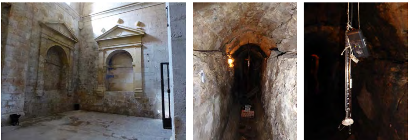
Figura 1. Monitorización de la cámara de drenaje-aireación de la iglesia de Santa Cruz la Real de Segovia, cámara piloto a) caracterización del ambiente de la iglesia y del muro mediante termohigrómetros (setiembre 2016); b y c) caracterización del muro y del ambiente de la cámara mediante termohigrómetros, anemómetro y evaporímetros (abril 2016).
