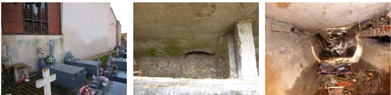
Figura 14. a) Muro oeste de la iglesia parroquial de Pinarejos (Segovia), manchas de humedad (febrero 2014, foto cedida por el Obispado de Segovia); b) Cámara de aireación de la iglesia parroquial de Villamor de los Escuderos (Zamora), tubo de evacuación de pluviales colmatado de arena (junio 2016); c) cámara de aireación de la iglesia de San Lorenzo de Toro (Zamora), canal de evacuación de pluviales lleno de suciedad (abril 2016).
