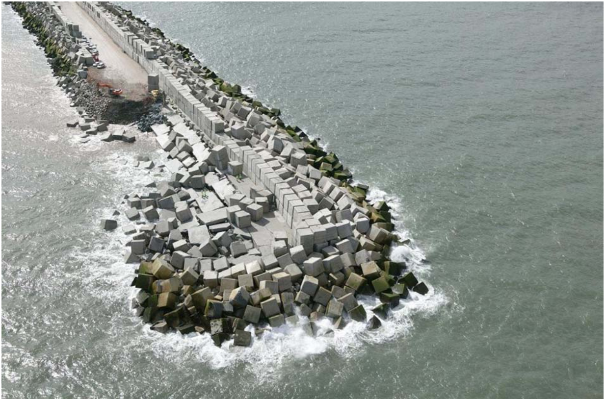
Figura 6. Avería de Cabo Torres en Marzo 2007. Manto de cubos
