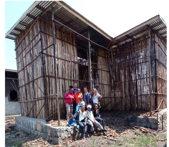
Figura 27: Vivienda en construcción donde es visible la estructura y cubrimiento de varas de eucalipto.
