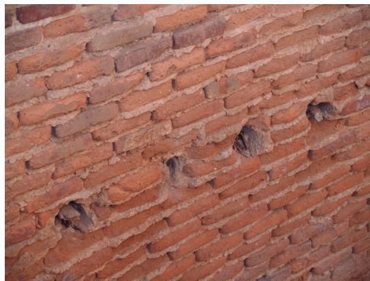
Fig. 3.437 Refuerzos de madera Arg-e-Tabriz (Autor)
