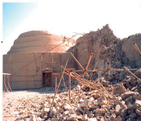
Fig.A.75 Casa de Hielo, terremoto 2003 (Motamed, J.)
