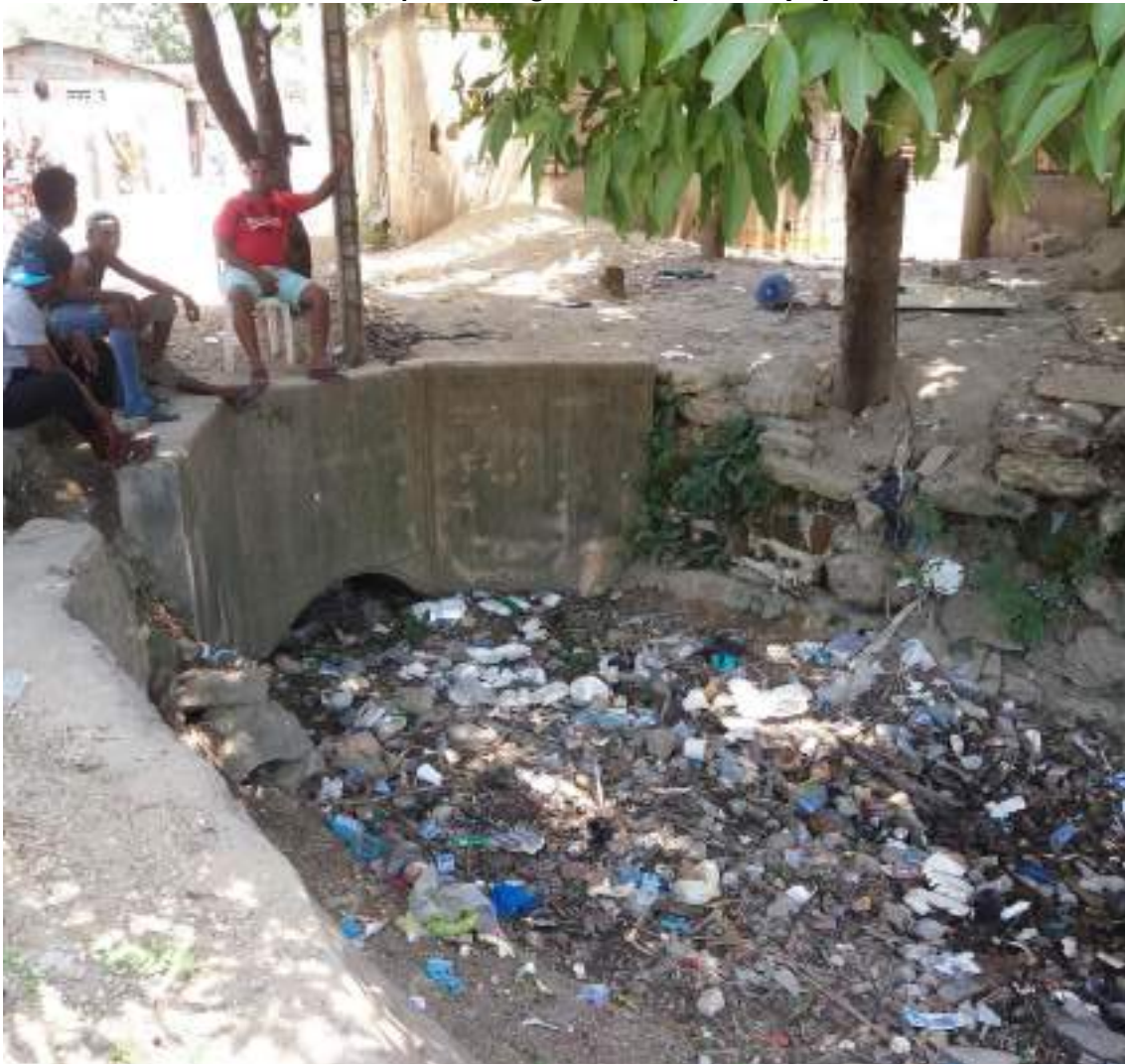
Encuentro de la cañada del INVI con las que vienen de Bella Vista y Villa Penca, tramo de confluencia final. Estrechamiento del cauce combinado con acumulación de basuras. Foto propia.
