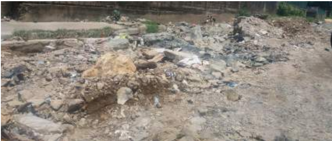
Calle del puerto afectada por su paso de las aguas en el tramo de desembocadura de la cañada.
