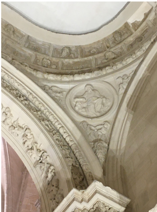
Pechina para bóveda oval. Catedral de Cuenca. Zaguán de acceso al claustro en brazo izquierdo del crucero.
