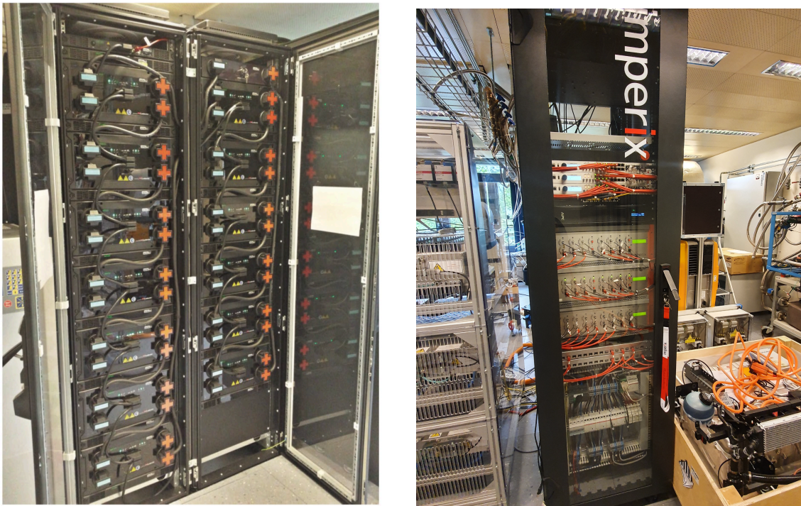
Figura 2.17: Sistema de baterías de la microrred del laboratorio DESL en la EPFL, Lausanne
