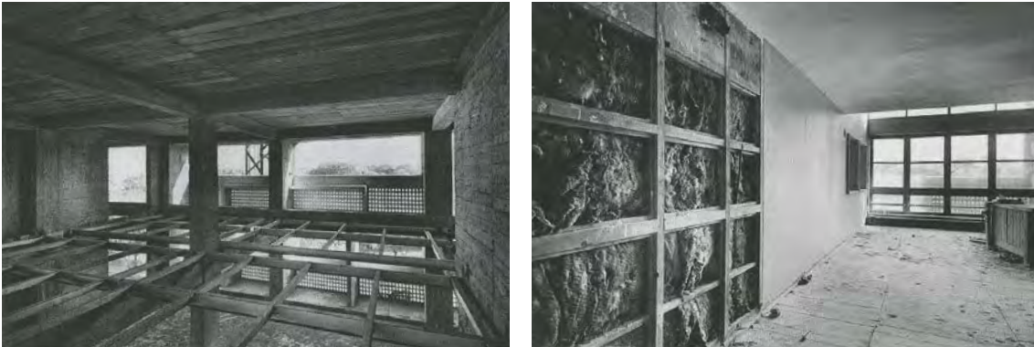
Estructura de hormigón armado y el esqueleto metálico de un apartamento. (Izquierda); paneles de revestimiento en los apartamentos (Derecha). Ambas fotografías del proyecto construido tomadas el 11 de noviembre de 1949.
