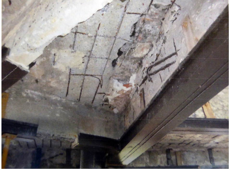
Figura 174. Lesiones estructura cubierta segunda planta RCNSS. Las piezas de acero bajo las vigas, fueron consideradas en el informe como "decorativas", dado que los elementos estructurales de hormigón no apoyaban sobre ellas. 2013. Beatriz Gil Rodríguez.
