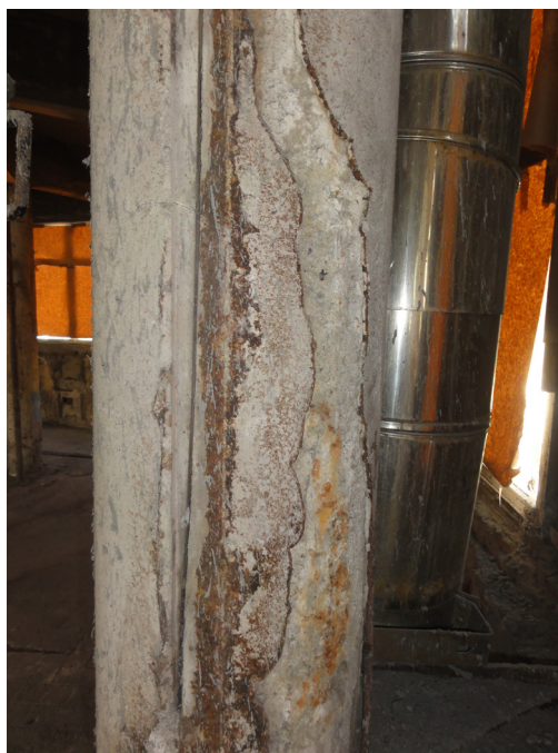
Figura 179. Corrosión y rotura de camisa de acero, probablemente de la intervención de Olasagasti en 1953. 2013. Miguel A. Ruano
