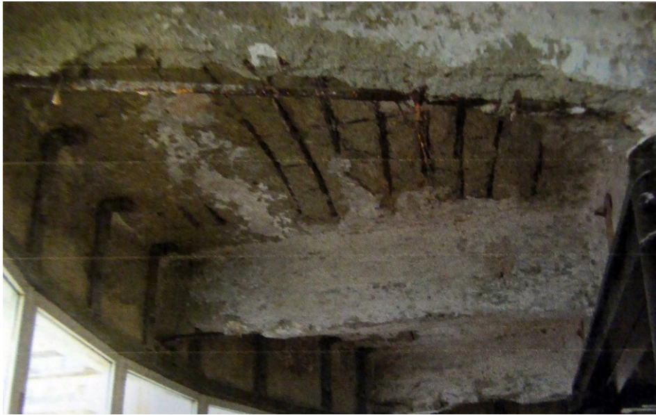
Figura 177. Estado de la estructura de cubierta en la parte frontal de la cubierta de la segunda planta del RCNSS. 2013. Beatriz Gil Rodríguez.
