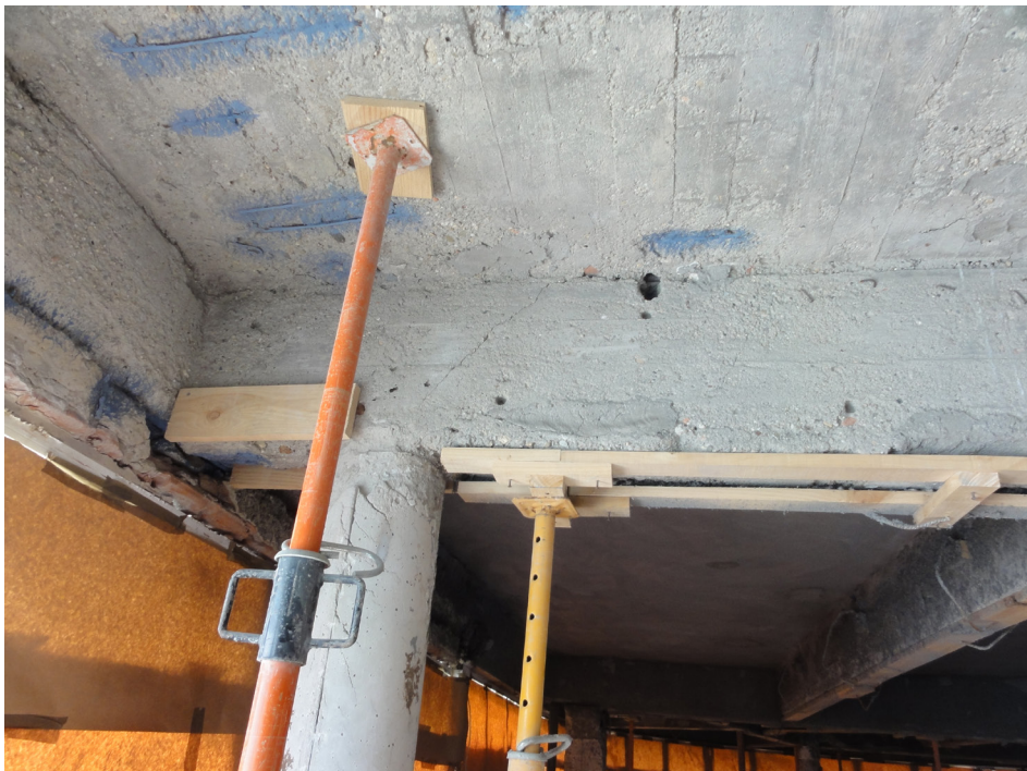
Figura 178. Rotura de la viga a cortante. La carpintería de la ventana corrida, había sido rebajada algunos centímetros, tal y como demuestra los rellenos de ladrillo en la parte superior de la carpintería, probablemente para dar cabida a las piezas en "U" metálicas que se pusieron debajo de las vigas. 2013. Miguel A. Ruano.
