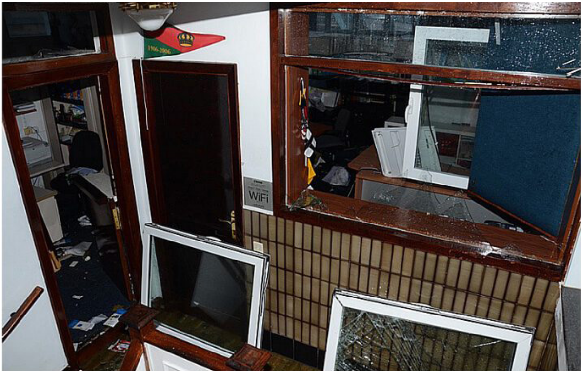
Figura 142. Daños instalaciones Real Club Náutico San Sebastián temporal 2014. Fuente RCNSS. https://www.rcnss.com/portfolio-item/09022014-2 . Consultado 28 agosto 2018
