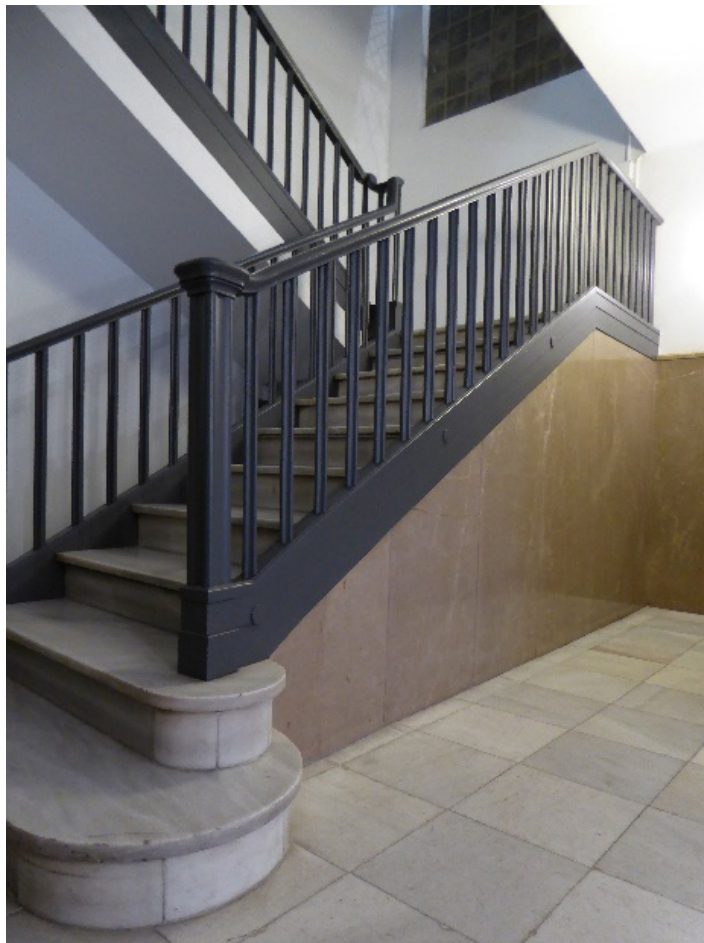
Figura 37. Detalle de la escalera del portal de Muntaner. Fotografía Miguel Á. Ruano
