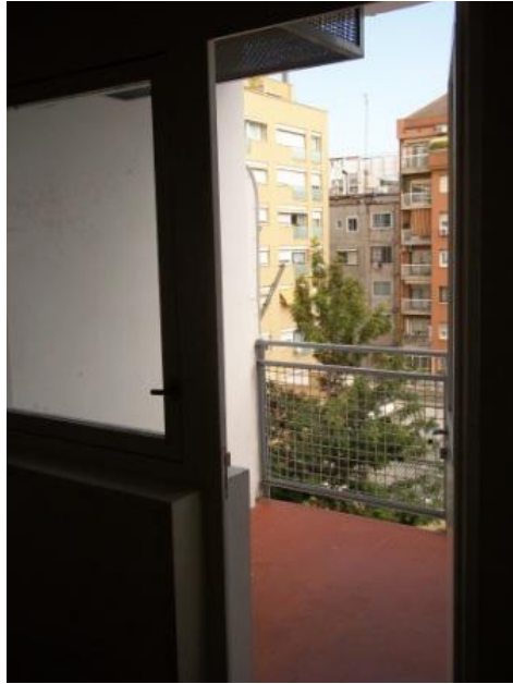
Figura 42. Nótese la variación de la carpintería y la caja de rejilla en el balcón para algún tipo de instalación. Dichas cajas no se encontraron en la fachada a Roselló, por lo que podría ser una vivienda interior. Vivienda sin identificar de Roselló 36. Fotografía facilitada por Fincas Lluria
