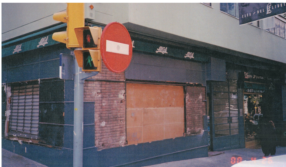
Figura 65. Estado de la fachada en la calle Muntaner tras la retirada del escaparate. Fotografía Linares Domenech. Exp 05-2000L04528. Arxiu Municipal del Districte de Sarrià Sant Gervasi (Barcelona)
