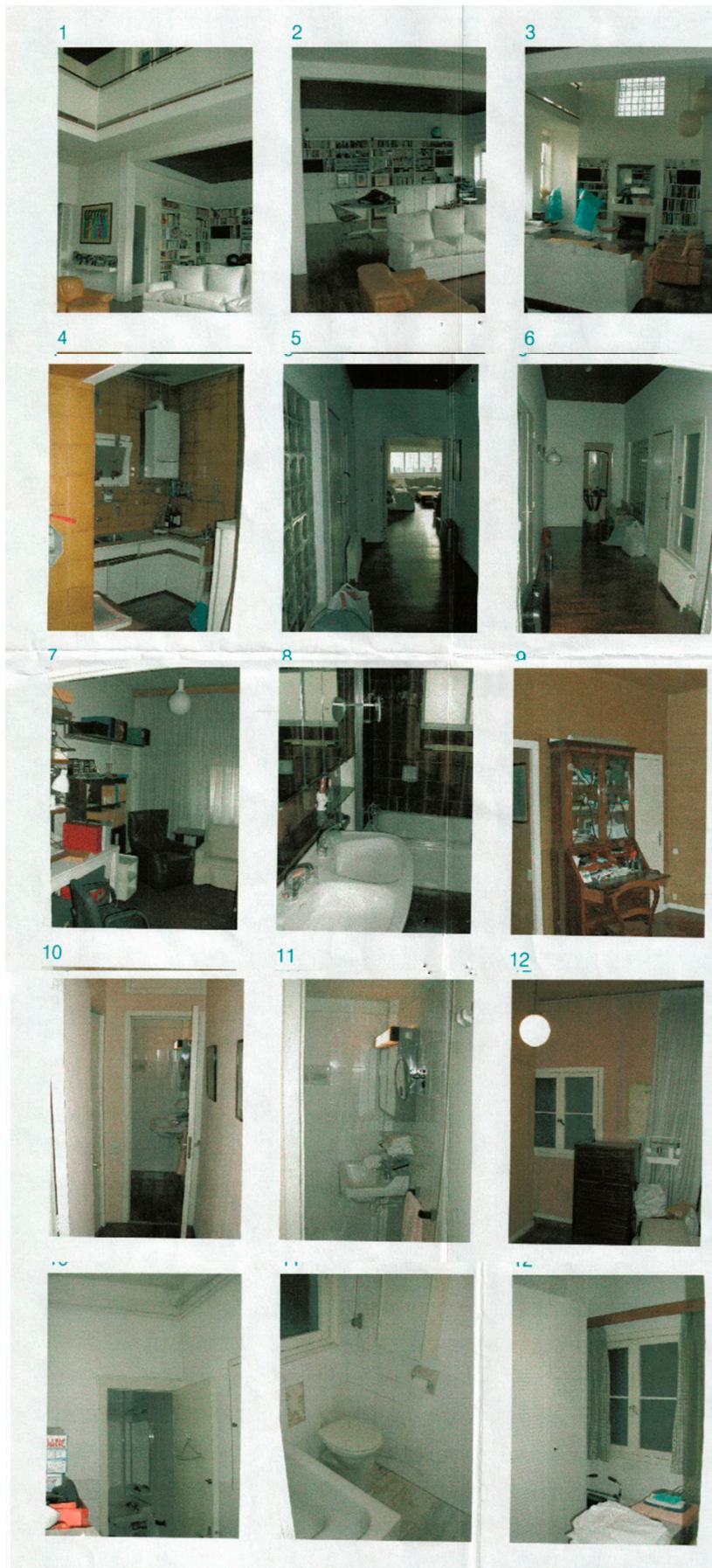
Figura 87. Fotografías del estado de la vivienda antes de la reforma. Martínez González, Patricio. Planos Varios. Expediente 05-2002L02192. Arxiu Municipal del Districte de Sarrià Sant Gervasi (Barcelona)
