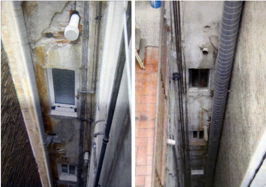
Figura 62. Detalle de dos de los patios de luces del edificio. Sin especificar en las fotos a cuál corresponde en el informe. De Ángel Castrel, Daniel. Memoria del proyecto. Expediente 02.2007L02734 Arxiu Municipal del Eixample
