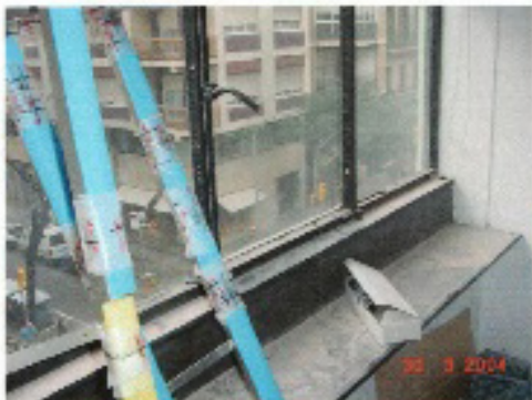
FLUSTERIA EXTERIOR METÀL·LICA A RESTAURAR
