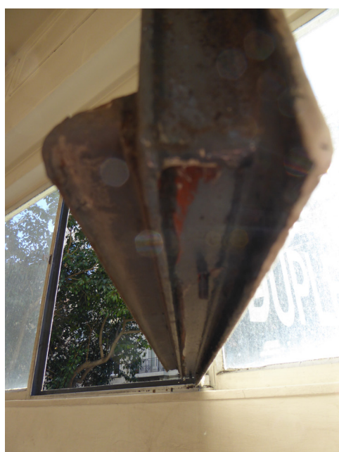
Figura 63. Detalle del estado de una de las carpinterías metálicas a la Calle Muntaner. 2015. Fotografía Miguel Ángel Ruano
