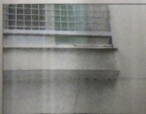
Patología en losa de balcones
