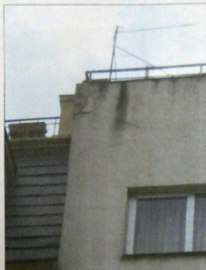
Patología en revoque de fachada principal
