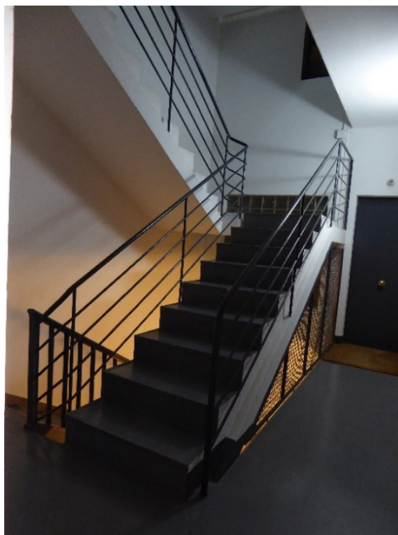
Figura 38. Detalle de la escalera en la primera planta de Muntaner. Obsérvese la unión entre la barandilla de madera d la planta baja a la barandilla de acero que continuará en el resto de las plantas. Fotografía Miguel Á. Ruano
