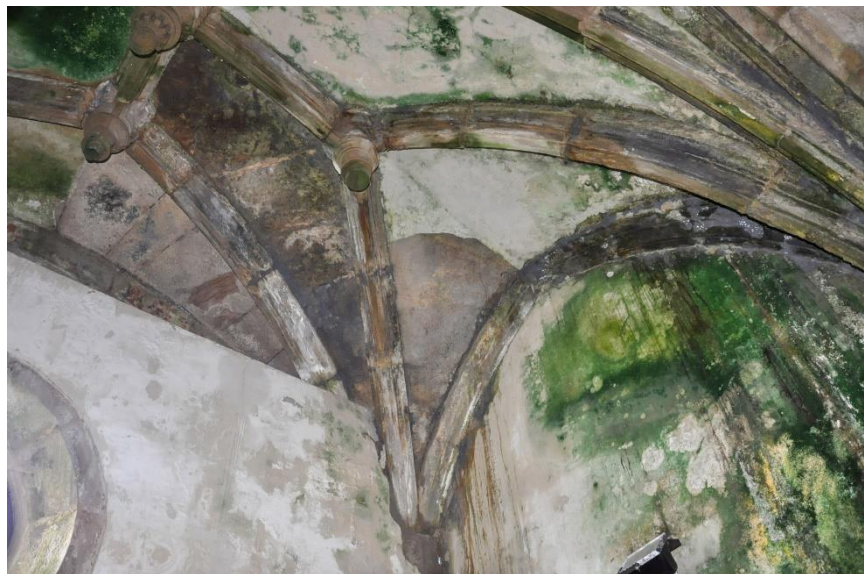
Fig. 3.10 - Imagen del interior de la sala intermedia en la que se pueden observar las humedades y el recrecido de la pared intersectando con los nervios.
