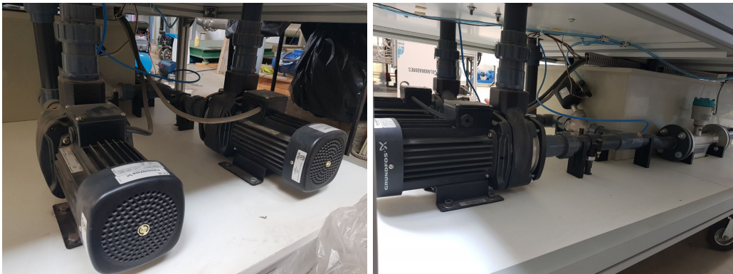
Figura 2.4: Localización de las dos bombas reales en la parte baja del banco de ensayo (imagen izquierda) y caudalímetro Coriolis (imagen derecha, junto al depósito). Fuente: E.P.
