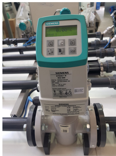
Figura 3.16: Caudalímetro electromagnético instalado en el banco de ensayo. Fuente: E.P.
