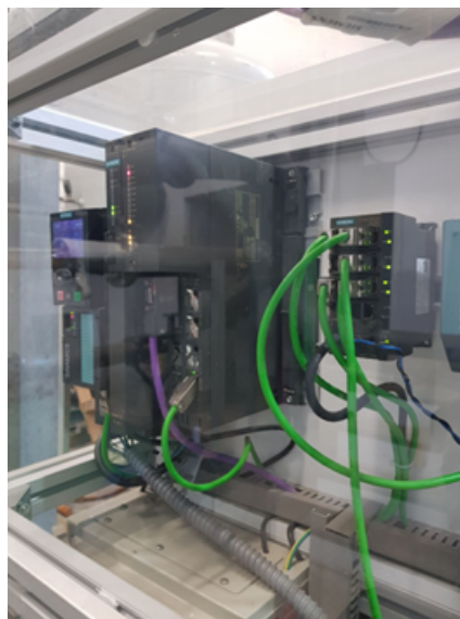
Figura 3.38: PLC. Fuente: E.P.
