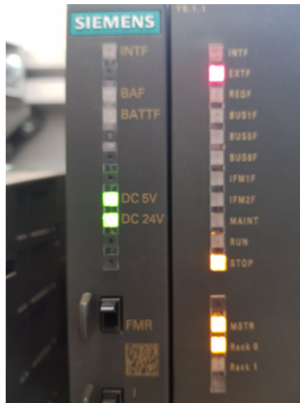
Figura 3.41: Encendido del PLC. Fuente: E.P.
