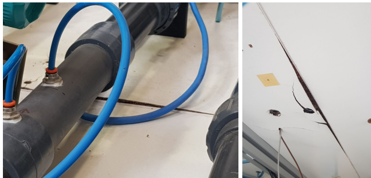
Figura 2.6: Tablón deteriorado debido a las fugas del transmisor de presión. Parte superior e inferior. Fuente: E.P.
