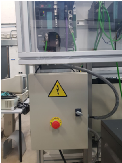
Figura 3.36: Cuadro eléctrico del banco de ensayo. Fuente: E.P.
