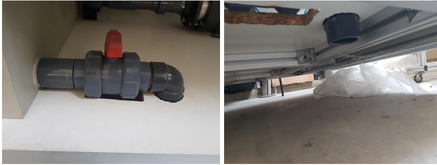
Figura 3.2: Vista de la tubería de vaciado y su llave de paso. Fuente: E.P.
