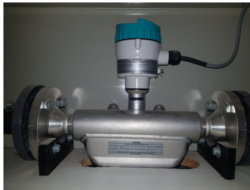
Figura 3.19: Caudalímetro coriolis instalado en el banco de ensayo. Fuente: E.P.
