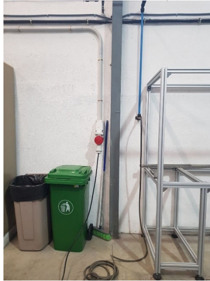
Figura 3.31: Conexión del compresor. Cable derecho. Fuente: E.P.
