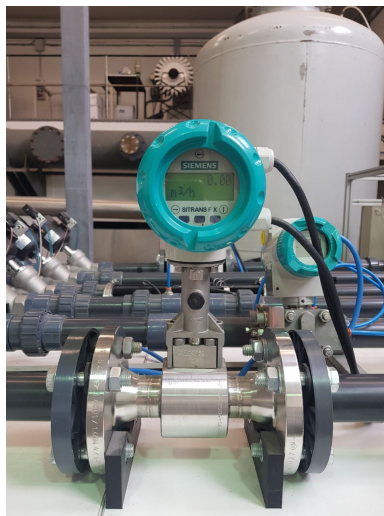
Figura 3.14: Caudalímetro Vórtex instalado en el banco de ensayo. Fuente: E.P.
