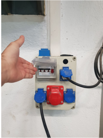
Figura 3.35: Detalle diferencial de regleta y compresor. Fuente: E.P.
