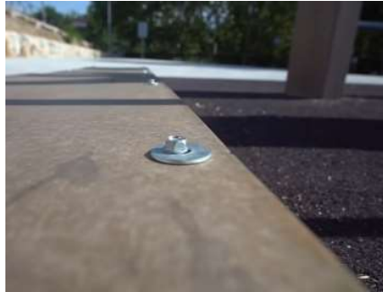
Figuras 3.4.15. Tablero roto en el parque de parkour de San Cristobal.
