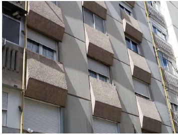
PRIMER DESPRENDIMIENTO DE UN ANTEPECHO
