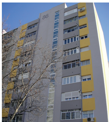
Catas en los bloques antes de la rehabilitación. Fuente: CREA Arquitectos consultores.
