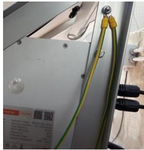
Figura 7.43. Conexión a tierra de los paneles [40]
