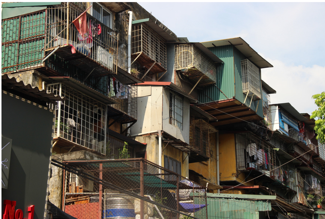
Fig. 258. Illegal apartment extensions in Khu tập thể Thanh Xuân Bắc, Hanoi. Source: author, 2019
