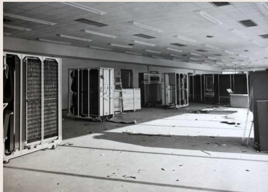
FOTOGRAFÍA DE LA INSTALACIÓN EN EL INTERIOR DE LA SALA DE MÁQUINAS O SALA DE CONTROL, EN LA PLANTA BAJA DEL CCUM. MOMENTO DE LA LLEGADA DE ALGUNOS DE LOS COMPONENTES TECNOLÓGICOS DEL IBM7090/IBM1401 A MADRID. NÓTESE QUE LAS REJILLAS DE IMPULSIÓN DEL AIRE YA ESTABAN DISPUESTAS ORTOGONALMENTE, PARALELAS A LOS PARAMENTOS VERTICALES, SIN TENER EN CUENTA LA DISPOSICIÓN DE LAS UNIDADES DE CINTAS SUGERIDA POR BRIONES. ESTA FOTOGRAFÍA MUESTRA QUE CUANDO ESTOS COMPONENTES LLEGARON A SU UBICACIÓN DEFINITIVA, LA CARCASA O EL CAPARAZÓN DEL SOPORTE FÍSICO DEL DA/DC YA ESTABA TERMINADO. CCUM. MADRID. CA. 1967-1968. MIGUEL FISAC. FUENTE: LÓPEZ, A., & MUNARRIZ, J. (2021). EL CENTRO DE CÁLCULO DE LA UNIVERSIDAD DE MADRID (1968-1973): CIENCIA, ARTE Y CREACIÓN COMPUTACIONAL . MADRID: EDICIONES COMPLUTENSE, P. 23.
