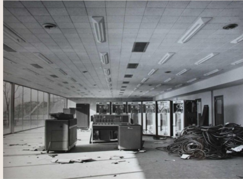
FOTOGRAFÍA DE LA INSTALACIÓN EN EL INTERIOR DE LA SALA DE MÁQUINAS O SALA DE CONTROL, EN LA PLANTA BAJA DEL CCUM. MOMENTO DE LA COLOCACIÓN DE LAS UNIDADES DE CINTAS EN FORMA DE MEDIA LUNA EN PLANTA, ABRAZANDO LA CONSOLA DE MANDO PRINCIPAL. NÓTESE LA MONTAÑA DE CONEXIONES, ENLACES Y CABLEADO DE LA DERECHA QUE LUEGO FUE OCULTADO POR EL SUELO TÉCNICO Y EL FALSO TECHO DEL SOPORTE FÍSICO. ADEMÁS, LAS REJILLAS DE IMPULSIÓN DEL AIRE, ASÍ COMO LAS PANTALLAS FLUORESCENTES DISEÑADAS POR FISAC YA ESTABAN DISPUESTAS ORTOGONALMENTE, PARALELAS A LOS PARAMENTOS VERTICALES, SIN TENER EN CUENTA LA DISPOSICIÓN DE LAS UNIDADES DE CINTAS SUGERIDA POR BRIONES. ESTA FOTOGRAFÍA MUESTRA QUE CUANDO LOS COMPONENTES TECNOLÓGICOS DEL IBM7090/IBM1401 LLEGARON A SU UBICACIÓN DEFINITIVA, LA CARCASA O EL CAPARAZÓN DEL SOPORTE FÍSICO DEL DA/DC YA ESTABA TERMINADO. CCUM. MADRID. CA. 1967-1968. MIGUEL FISAC. FUENTE: LÓPEZ, A., & MUNARRIZ, J. (2021). EL CENTRO DE CÁLCULO DE LA UNIVERSIDAD DE MADRID (1968-1973): CIENCIA, ARTE Y CREACIÓN COMPUTACIONAL . MADRID: EDICIONES COMPLUTENSE, P. 34.
