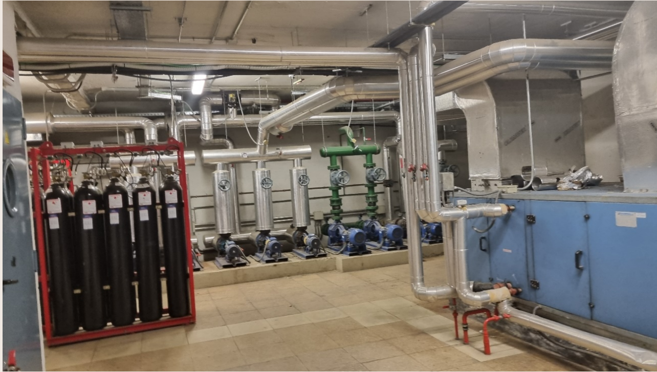
IMAGEN DEL INTERIOR DE LA INSTALACIÓN HIPER EQUIPADA DEL ACONDICIONAMIENTO DE AIRE, EL CONTROL HIGROTÉRMICO DEL INTERIOR Y LA INSTALACIÓN CONTRA INCENDIOS DEL ACTUAL SERVICIO DE INFORMÁTICA, CENTRO DE PROCESO DE DATOS (CPD) DE LA UNIVERSIDAD COMPLUTENSE DE MADRID. MADRID. 15 DE FEBRERO 2023. FUENTE: FOTOGRAFÍA DE LA AUTORA.
