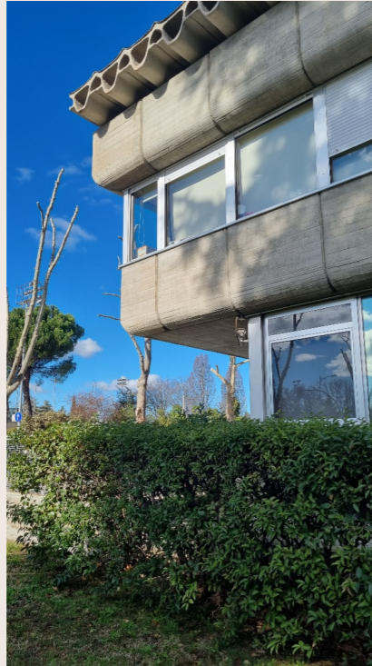
DETALLE ACTUAL DE LA ESQUINA CON LOS ANTEPECHOS DE HORMIGÓN VISTOS, LAS VIGAS-HUESO Y LAS NUEVAS CARPINTERÍAS EXTERIORES, PERSIANAS Y ESTORES DEL SOPORTE FÍSICO DEL ANTIGUO CCUM. HOY ES EL SERVICIO DE INFORMÁTICA, CENTRO DE PROCESO DE DATOS (CPD) DE LA UNIVERSIDAD COMPLUTENSE DE MADRID. MADRID. 15 DE FEBRERO 2023. FUENTE: FOTOGRAFÍA DE LA AUTORA.
