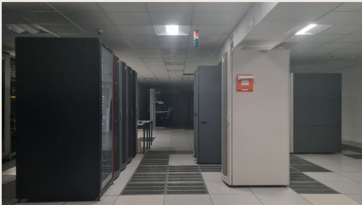
IMAGEN DEL DC ACTUAL (14 SERVIDORES) EN LA PLANTA SÓTANO DEL ANTIGUO CCUM. HOY ES EL SERVICIO DE INFORMÁTICA, CENTRO DE PROCESO DE DATOS (CPD) DE LA UNIVERSIDAD COMPLUTENSE DE MADRID. MADRID. 15 DE FEBRERO 2023. FUENTE: FOTOGRAFÍA DE LA AUTORA.
