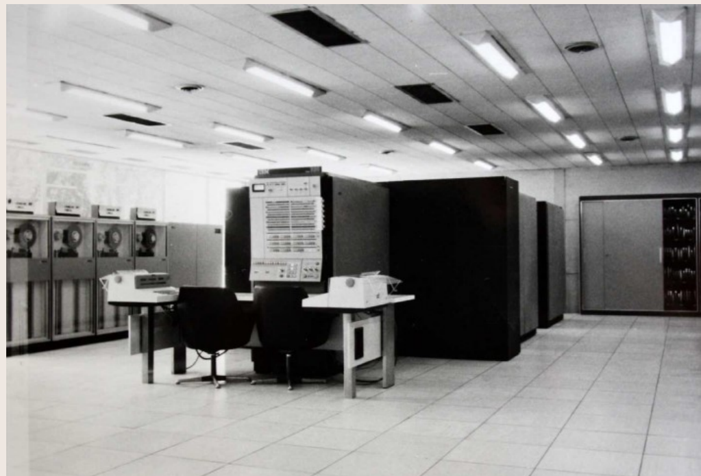
IMAGEN DEL INTERIOR DE LA PARTE MÁS AL OESTE DE LA PLANTA BAJA DEL CCUM, EN LA SALA DE CONTROL O DE MÁQUINAS. PUEDE OBSERVARSE LAS LOSETAS REGISTRABLES DE UN COLOR CLARO DEL NUEVO SUELO TÉCNICO INSTALADO. CA. 1969. CCUM. MADRID. MIGUEL FISAC. LÓPEZ, A., & MUNARRIZ, J. (2021). EL CENTRO DE CÁLCULO DE LA UNIVERSIDAD DE MADRID (1968-1973): CIENCIA, ARTE Y CREACIÓN COMPUTACIONAL . MADRID: EDICIONES COMPLUTENSE, P. 31.
