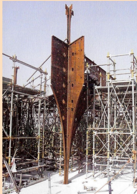
IMAGEN DEL PROCESO CONSTRUCTIVO CAJANEGRIZADO DEL SOPORTE Y EL ARCO ENCOGIDOS, MÁS ESBELTOS, DELGADOS Y FINOS DE LO NORMAL. DA TAMA ART UNIVERSITY LIBRARY, HACHIOJI, TOKIO, JAPÓN (2007), TOYO ITO & ASSOCIATES. 2004-2007. FUENTE: ITO, T. (2012). EN TURNBULL J. (ED.), TOYO ITO: FORCES OF NATURE . NUEVA YORK: PRINCETON UNIVERSITY SCHOOL OF ARCHITECTURE PRINCETON ARCHITECTURAL PRESS, P. 42.
