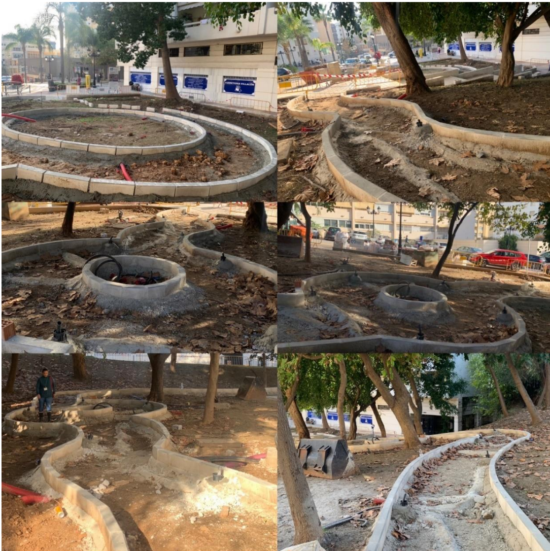
Imagen 22. 'El Jardín de los Sentidos'. Circuitos de luminarias soterrados bajo el hormigón impreso. Elaboración propia.
