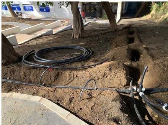
Imagen 25. 'El Jardín de los Sentidos'. Instalación del sistema de riego. Elaboración propia.
