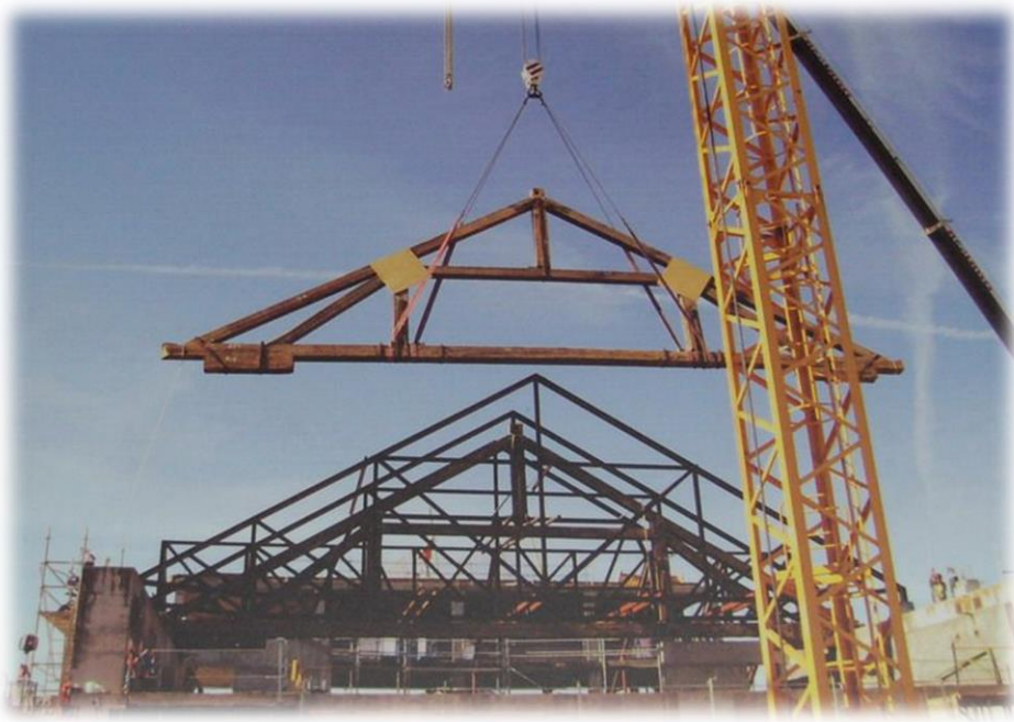
Figura 3. Fotografía del desmontaje de la cubierta del Teatro Real Carlos III de Aranjuez, España. Foto: Bayón Arquitectos S.A.
