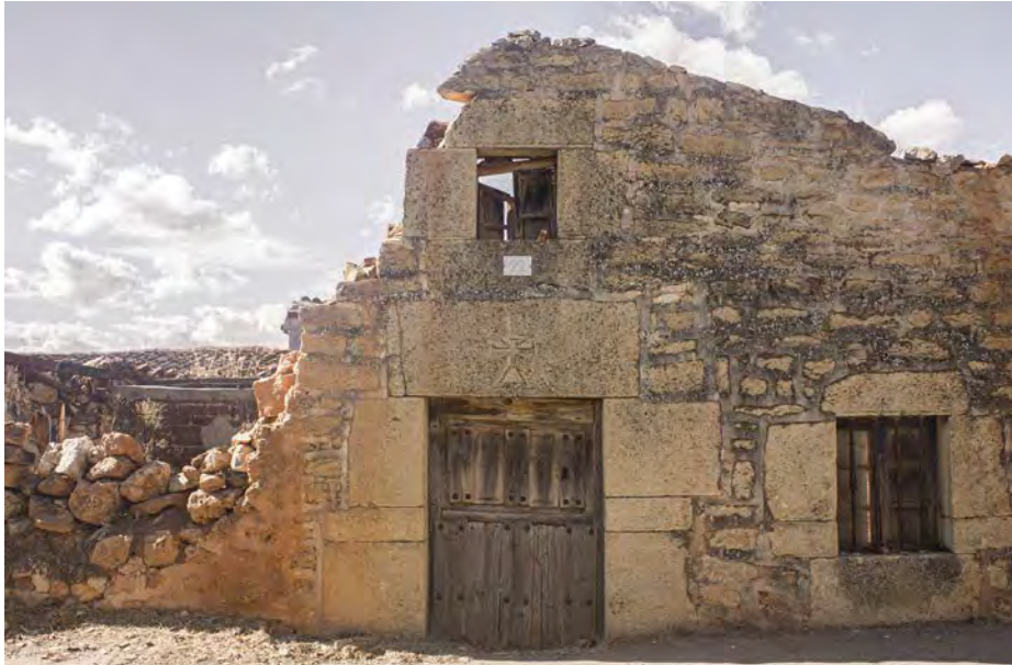
Figura 2.29: vivienda en ruinas en Revilla del Campo.
