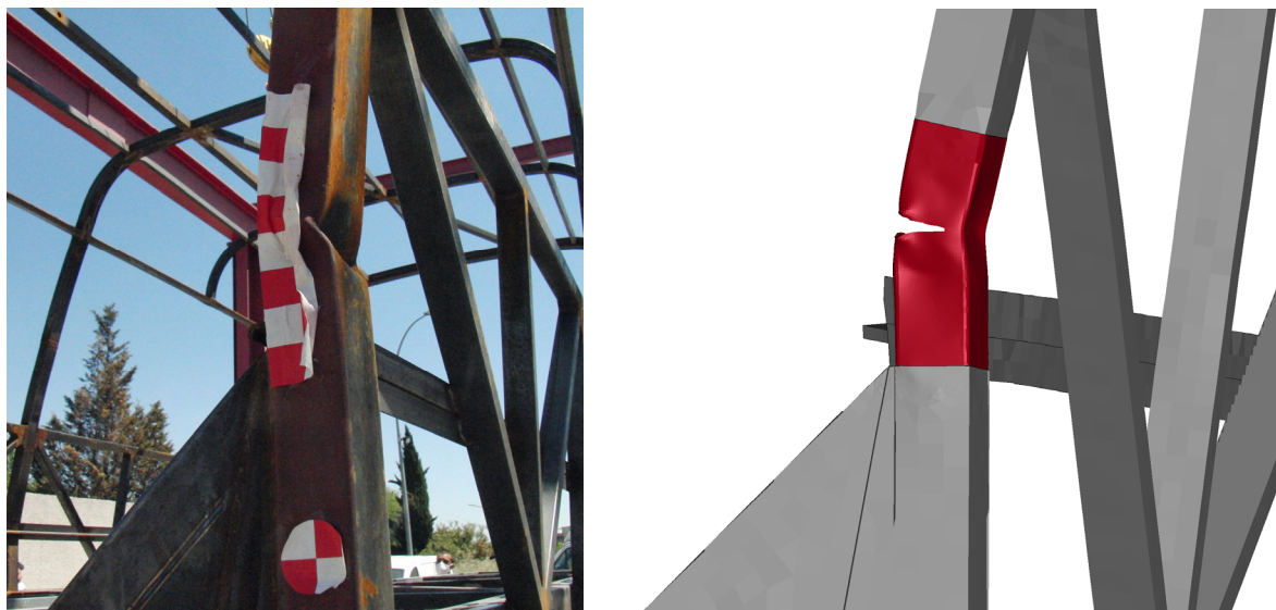
Figura 160. Grieta en montante zona de piso. Modelo M.E.F. y ensayo.
